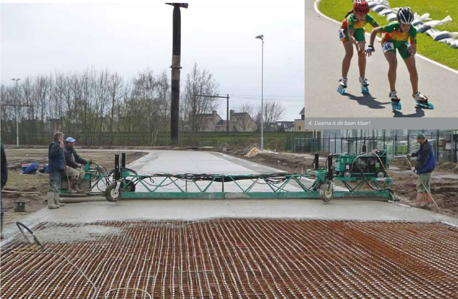
3. Een zogeheten 'spreidmachine' stort met een betonmixer de vloeibare toplaag op de baan waarna de spreidmachine dit egaliseert en verdicht. De toplaag wordt daarna met een speciale schuurmachine opgepoetst.
