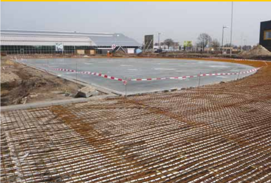
1. 20 centimeter onder de toplaag van het sportveld wordt het (koel)leidingennet met zijn wapening aangelegd. Wat niet te zien is, zijn de acquiers – de leidingen die verticaal de grond in gaan.
