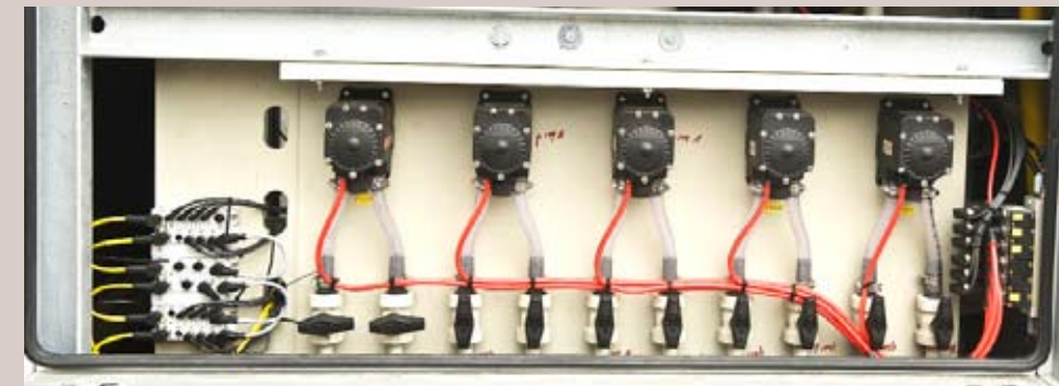
De besturing van de raffinerij is complex en voorzien van de modernste elektronica
