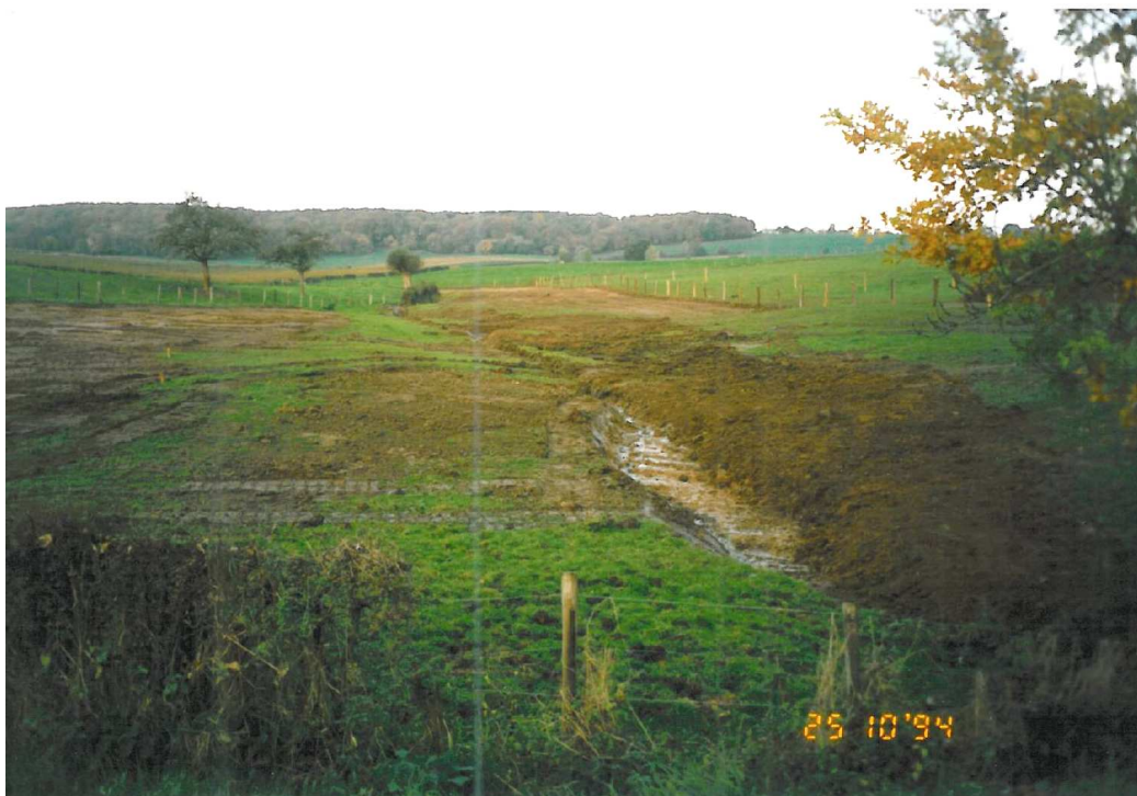
Foto B. Beekdalletje na afronding van de graafwerkzaamheden. De vrijgekomen grond is uitgespreid over delen van het perceel. Het gehele gebied is voorzien van een veeraster, waardoor een brede bufferstrook is ontstaan (25 okt. 1994).
