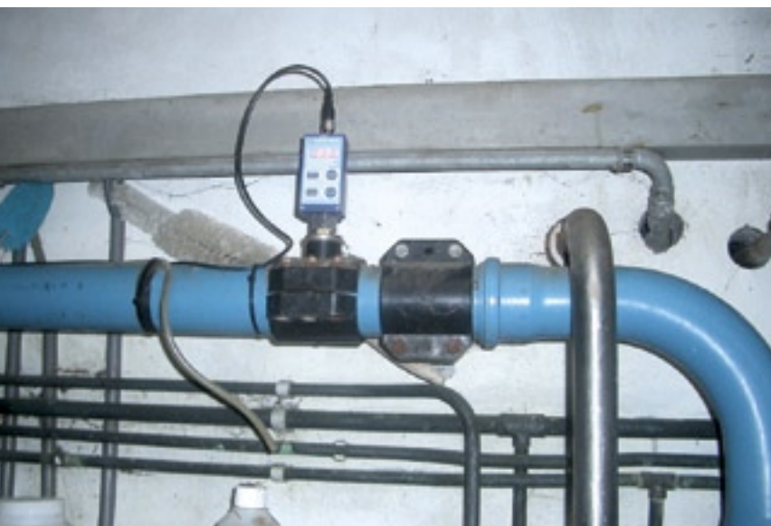
Een vacuümsensor meet het vacuüm en geeft deze waarde door aan de frequentieregelaar. Deze kan dan zonodig bijsturen naar het gewenste vacuüm.
