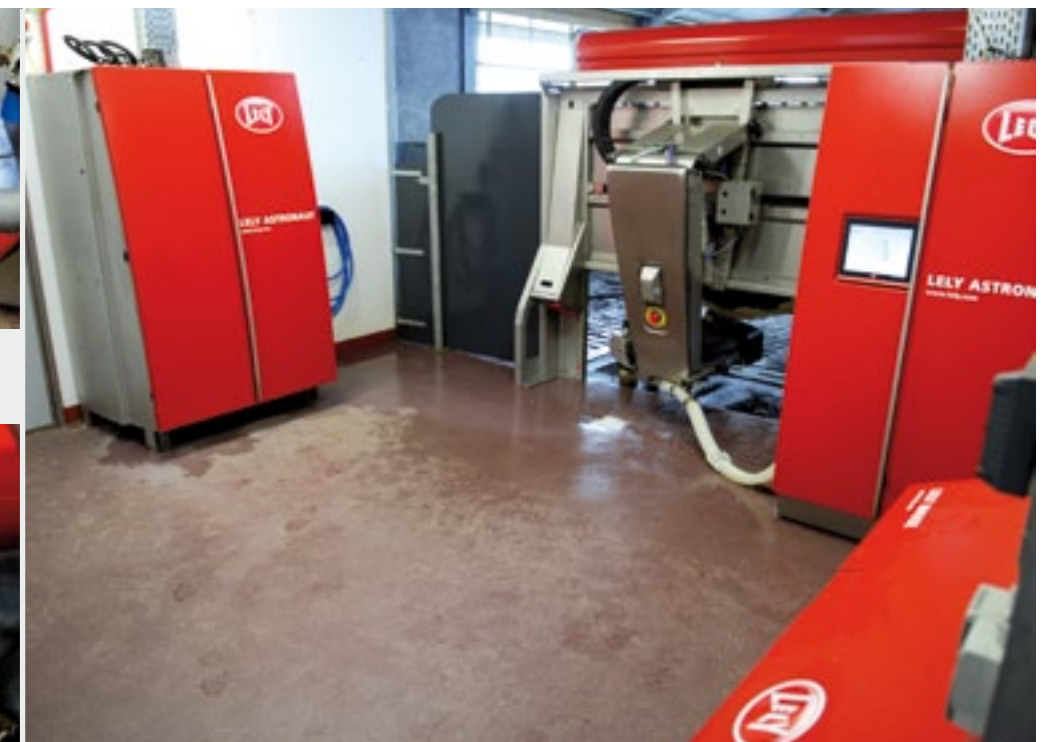
Het melklokaal met de nieuwe Lely Astronaut A4. Links de centrale unit met vacuümpomp, boiler en reinigingsmiddelen. Doordat deze unit, die twee robots bedient, niet in de robot is geïntegreerd, werd die 90 cm korter.
