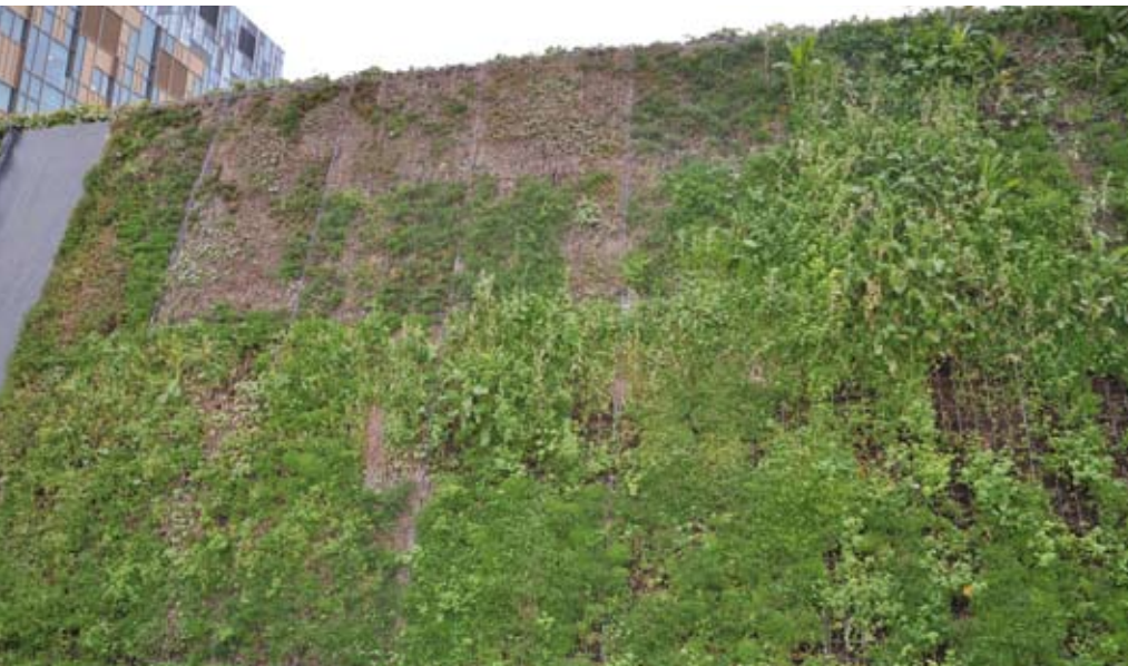
Sedumsysteem in Londen onevenwichtige irrigatie boven te droog beneden te nat uitgespoeld substraat en kale plekken waarop onkruiden weelderig groeien.
