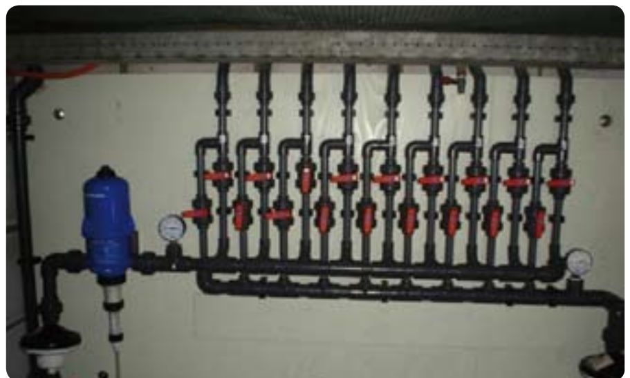
Afb. 1: Schakelpaneel voor drinkwater en medicijnen leiding met reduceerventielen, kranen en een dosator (Michel van den Bergh, Vitelia).
