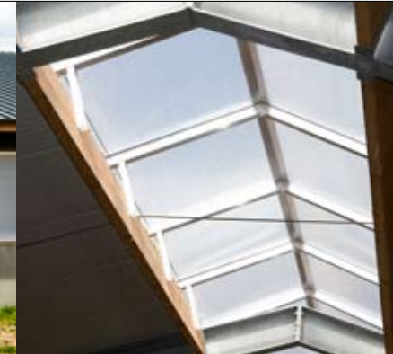
Ventilatie nok van polycarbonaatplaten
