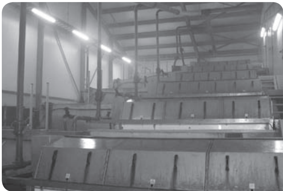
Hal met zicht op zes van de acht trommelfilters die elk het water afkomstig van één laag basins (race ways) zuiveren.
