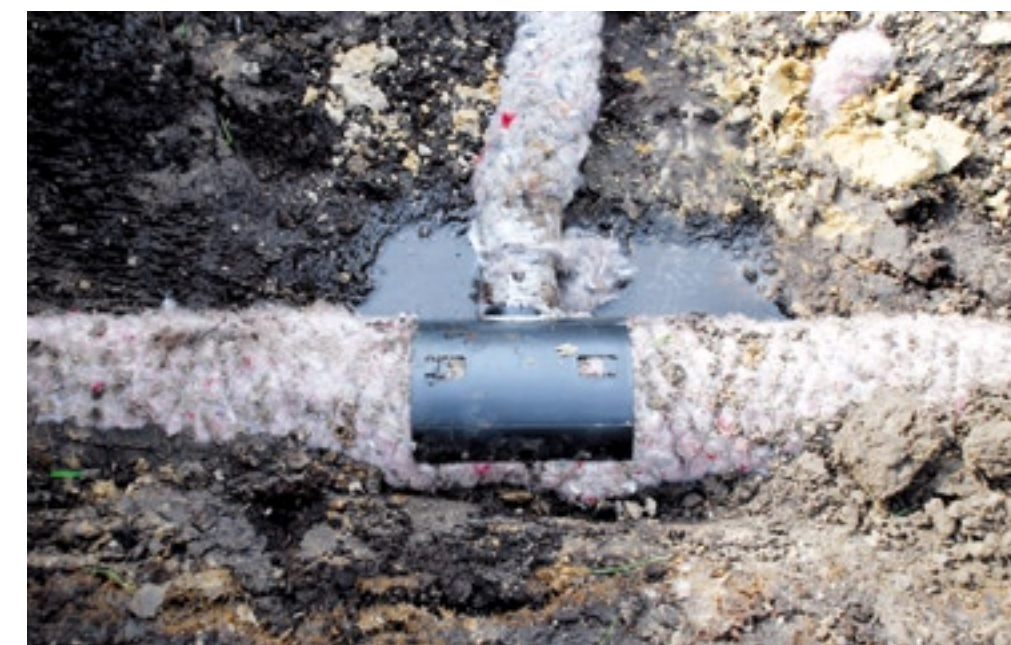
▲ De dunnere drainageslang is met een T-stuk op de 125 mm hoofddrain aangesloten.
