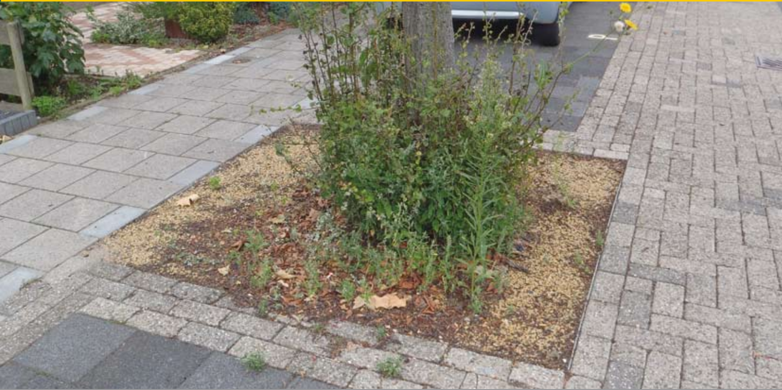
Voorbeeld van opschot van pyrus dat door het epoxy of siersplitdrainage heen groeit. Onkruid verwijderen wordt dan heel lastig.
