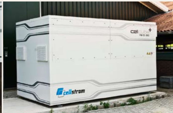
De redox-flow-batterij van Cellstrom slaat de opgewekte energie op
