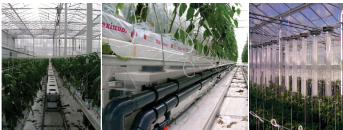
Figuur 1. De JSK installatie zoals geïnstalleerd in afdeling 6.
