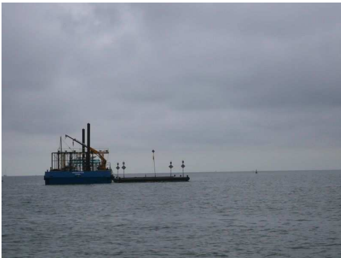
Figuur 10: De palen en het ponton in het Malzwin. Op de onderste foto is ook het installatie en oogstschip te zien.
