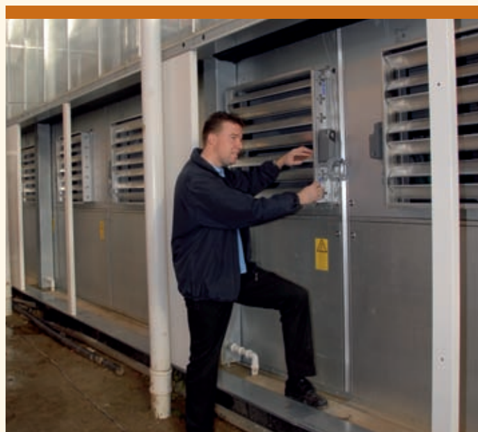
Van Elswijk controleert het kleppenregister aan de buitenkant van de luchtbehandelingskast. Langs deze weg wordt de buitenlucht aangezogen.
