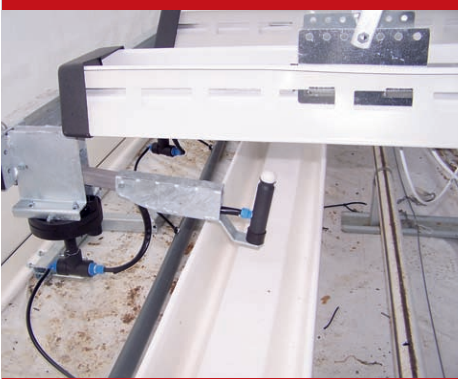
Voor de watergift hebben Revaho en FormFlex een ingenieus systeem ontwikkeld, waarbij een pylon van onderaf automatisch aan de druppelslang van de goot wordt gekoppeld.
