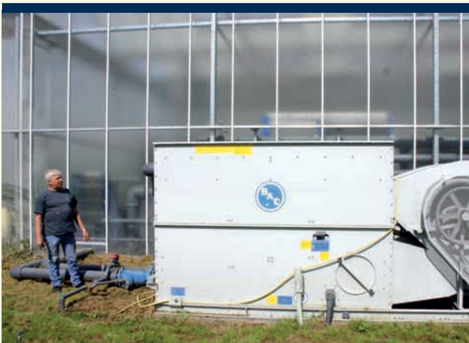
Verwarming, koeling en ontvochtiging van de kas vinden via de vier grote luchtbehandelingskasten aan de gevel plaats, waar de kaslucht met acht grote elektrische ventilatoren doorheen wordt getrokken.
