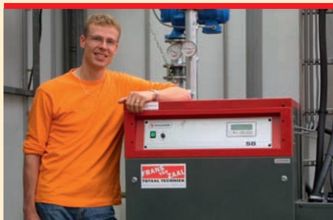
Martien Klein: "Een ketel met een 450 kW elektrisch vermogen sloot het beste aan op Hans' bedrijfssituatie. We hebben daarom twee verwarmings-elementen uit deze standaardketel verwijderd."
