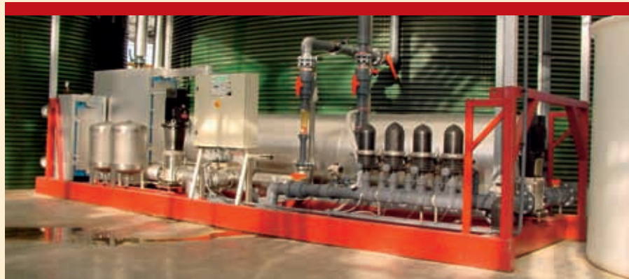
Deze Ecoster K verhitter bij van Gog in Asten heeft een capaciteit van 50 m 3 /h en is aangesloten op de aanwezige warmtebron van het bedrijf (foto: Van Dijk Heating BV).
