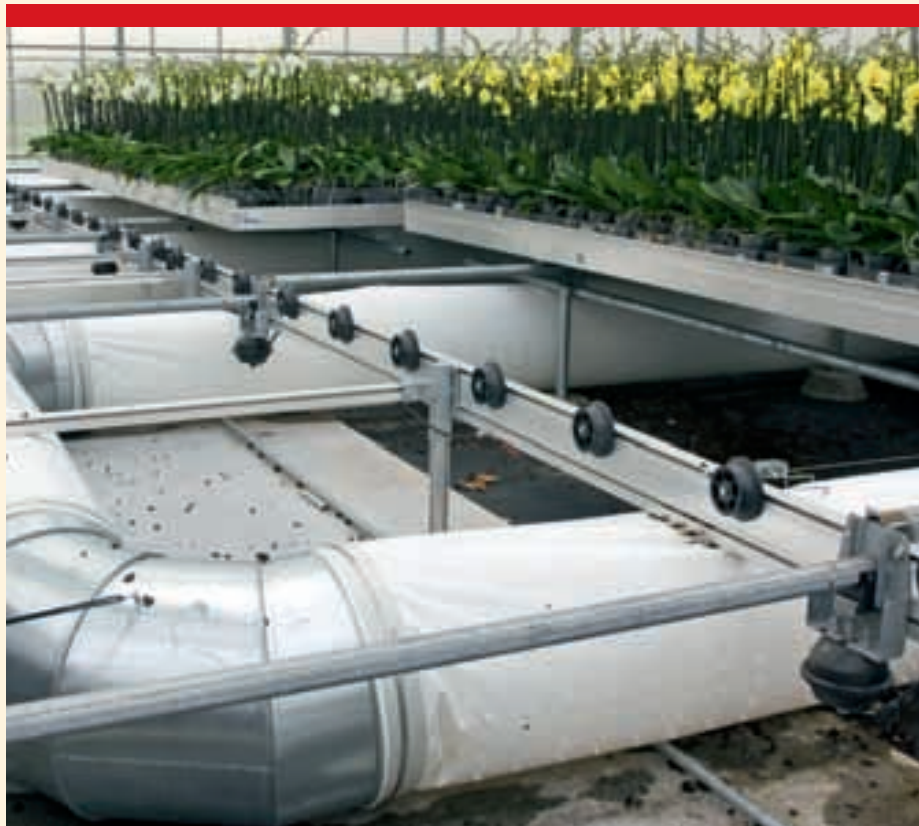
De installateur berekende het gatenpatroon. Op bepaalde plaatsen steken er kleine buisjes uit de slangen. Een idee van de teler om de luchtstroom op een bepaalde manier te laten verlopen.
