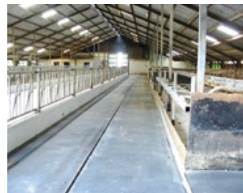
Een niet afgewerkte nieuwe gietasfalt toplaag in een bestaande stal. Aan de randen is de elastische mortel te zien.
