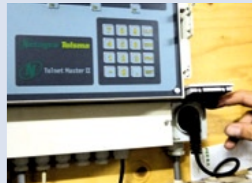
▲ De bewaarcomputer is het centrale brein van de bewaring. Hierin komen alle meetwaarden samen en de betrouwbaarheid hangt af van een juiste werking. Een eenvoudige tip is om altijd spanning op de computer te laten staan. Dit voorkomt condensvorming op de onderdelen. Laat dus altijd de stekker in het stopcontact, ook na het uitschuren.
