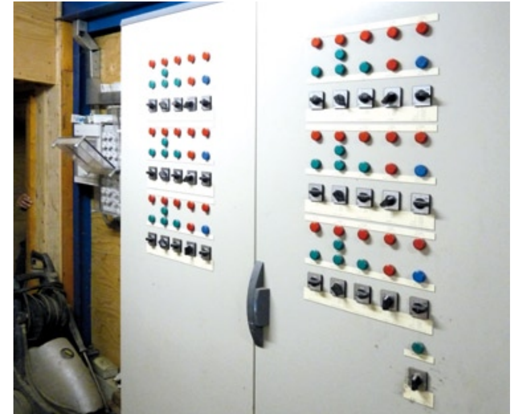
▲ Zelf onderhoud aan de aardappelbewaring doen, schrikt vaak al af als je de indrukwekkende schakelkasten ziet. Zo'n kast is ook het werk van de specialist. Toch is er nog heel wat zelf uit te voeren.
