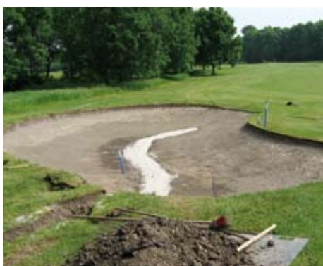
De ondergrond en de drainagegeul (gevuld met drainage en grind) zijn klaar voor zand.
