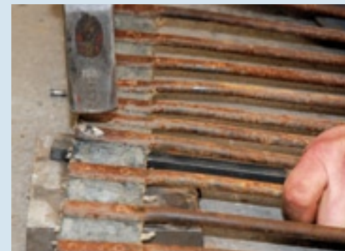
▲ Nadat de oude klinknagel en spijl zijn verwijderd, wordt de nieuwe spijl geplaatst. Het gat van de nieuwe spijl loopt aan beide zijden taps toe. De klinknagel wordt ingestoken van de zijde die over de aandrijfrollen loopt. Klop aan de bovenzijde van de klinknagel met een hamer uit. Ondersteun hierbij de onderkant van de klinknagel goed. Leg de klinknagel op een stuk metaal waardoor hij niet weg kan.
