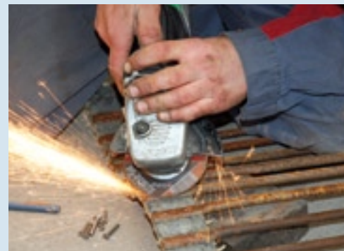
▲ Wanneer de rooimat van de rooimachine is verwijderd, leg je deze uit tot het punt waar een spijl van de rooimat moet worden vervangen. Om de kapotte spijl te vervangen, slijp je de klinknagel en een deel van de oude spijl weg. Hierbij moet je voorkomen dat de rubberen band waardoor de spijlen met elkaar verbonden zijn, niet in de brand gaat of op een andere manier beschadigd raakt.
