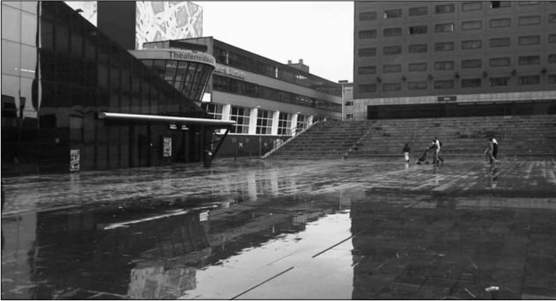
Fig. 3.13 Slippery tiles on Spuiplein, Den Haag
