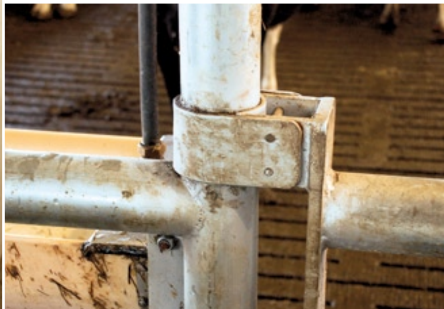
Afgeronde scharnieren veroorzaken geen wonden bij koeien. Slijp uitstekende bouten af zodat koeien zich niet kunnen verwonden.
