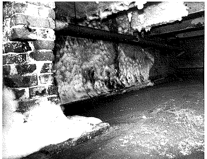
Schimmel in kruipruimte
