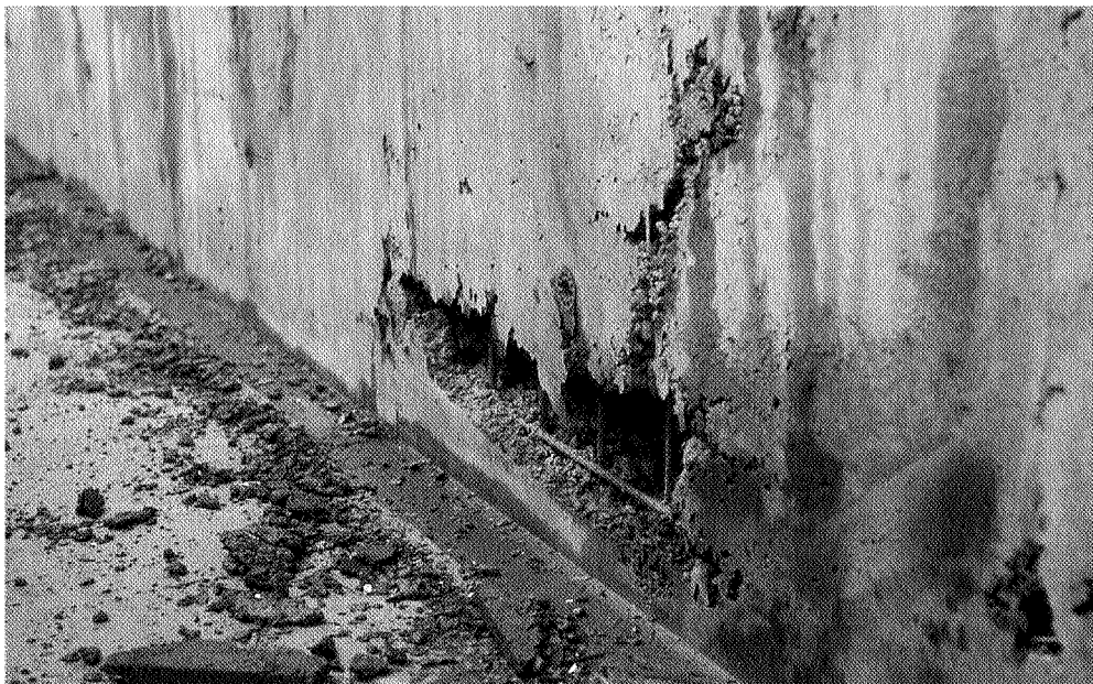
Grindnesten kunnen onder meer ontstaan doordat onder uit de kist cementpasta wegglekt als deze niet voldoende dicht op de vloer aansluit
