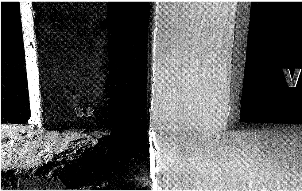
Bij het verwijderen van de bekisting komen allerlei onvolkomenheden aan het licht, zoals afgebroken hoeken en randen. Reparatie is geboden foto: Marten Sandburg/penn
