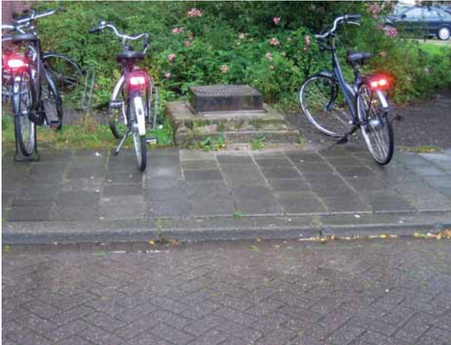
In een gemeente met een slappe bodem kunnen onderheide putten voor overlast zorgen door zettingen van de omgeving eromheen (foto: GeoDelft).
