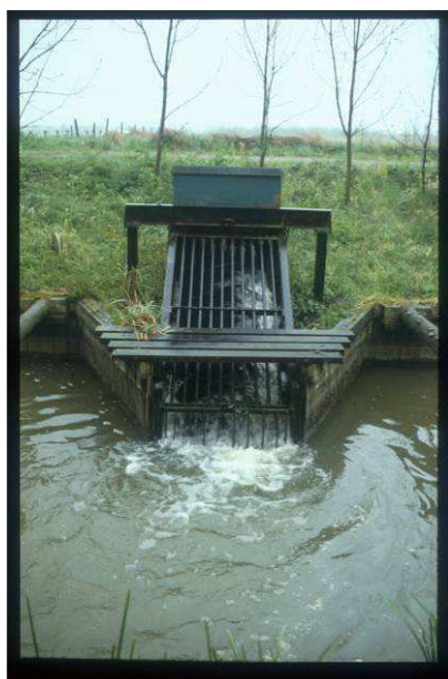
figuur 8.4 Een voorbeeld van een vijzelgemaal.
