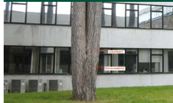
Bliksemafleider in de boom met Arborbolt en downconductor.
