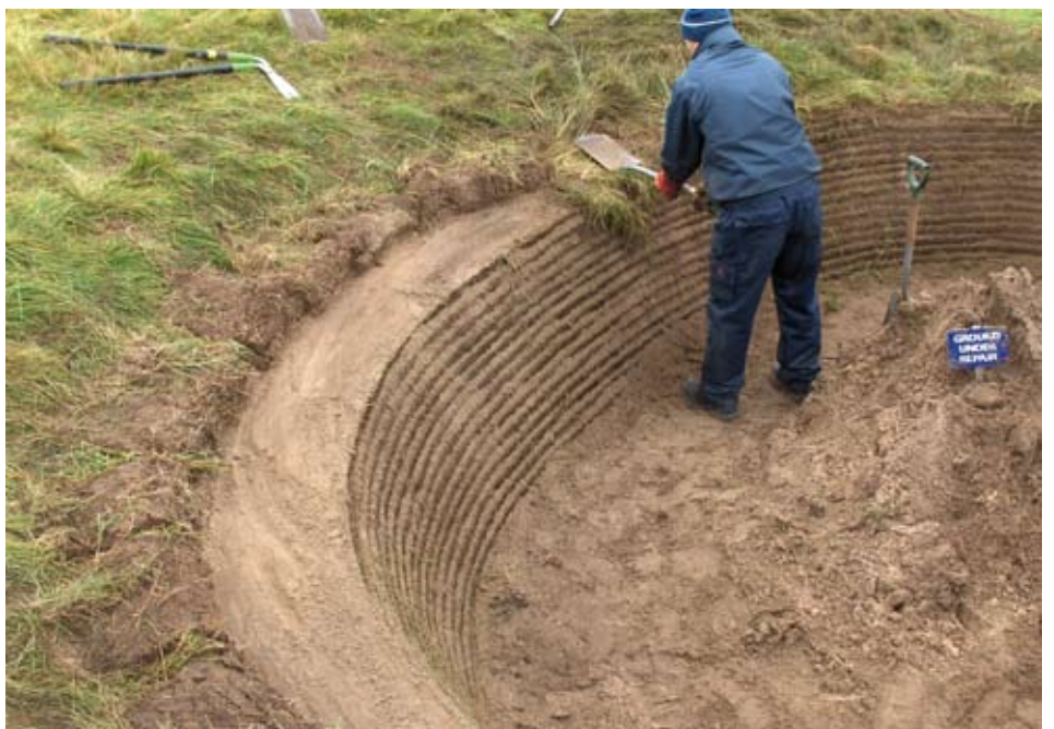
Zelfs een paar dagen tijd om te helpen één van de 28 bunkers te revetten.
