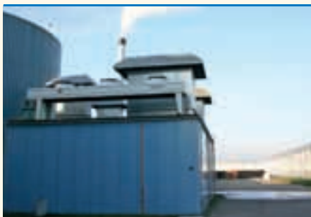
Het cluster beschikt over twee WKK-installaties.
