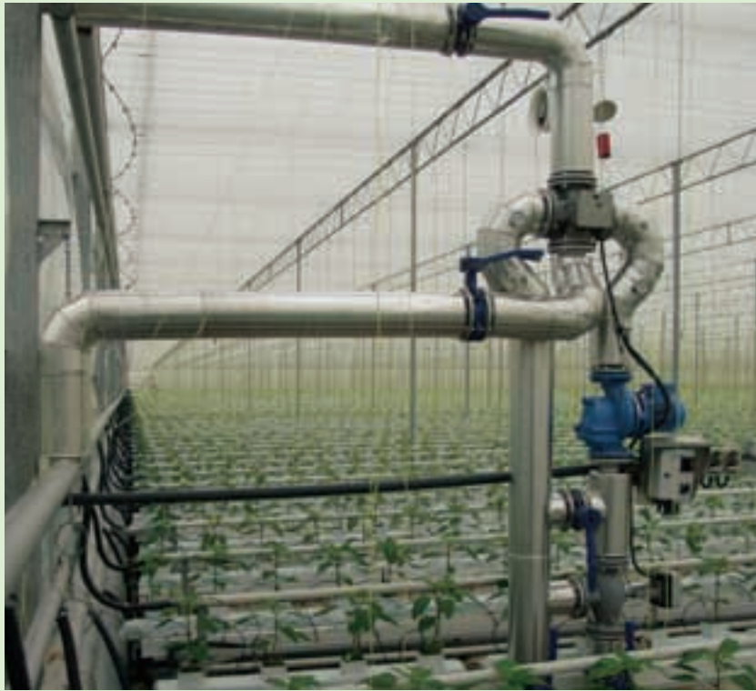
Bij Vreugdenhil in Maasdijk is elke groep opgebouwd uit een drieweg regelafsluiter met daar bovenop een vierweg mengkraan voor het omkeren van de aanvoer en de retour.
