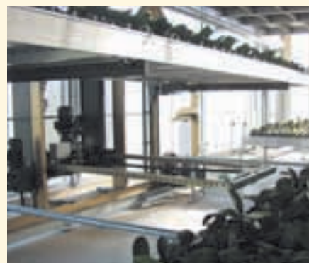
De automatische gevelwagen.
