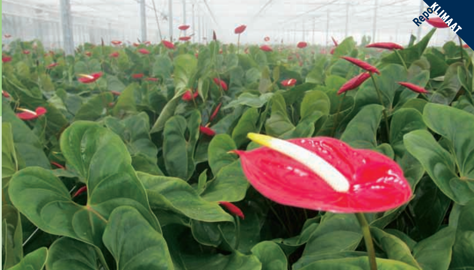
De vernevelingsinstallatie produceert een rookfijne mist in de kas, zonder dat het personeel er nat van wordt.
