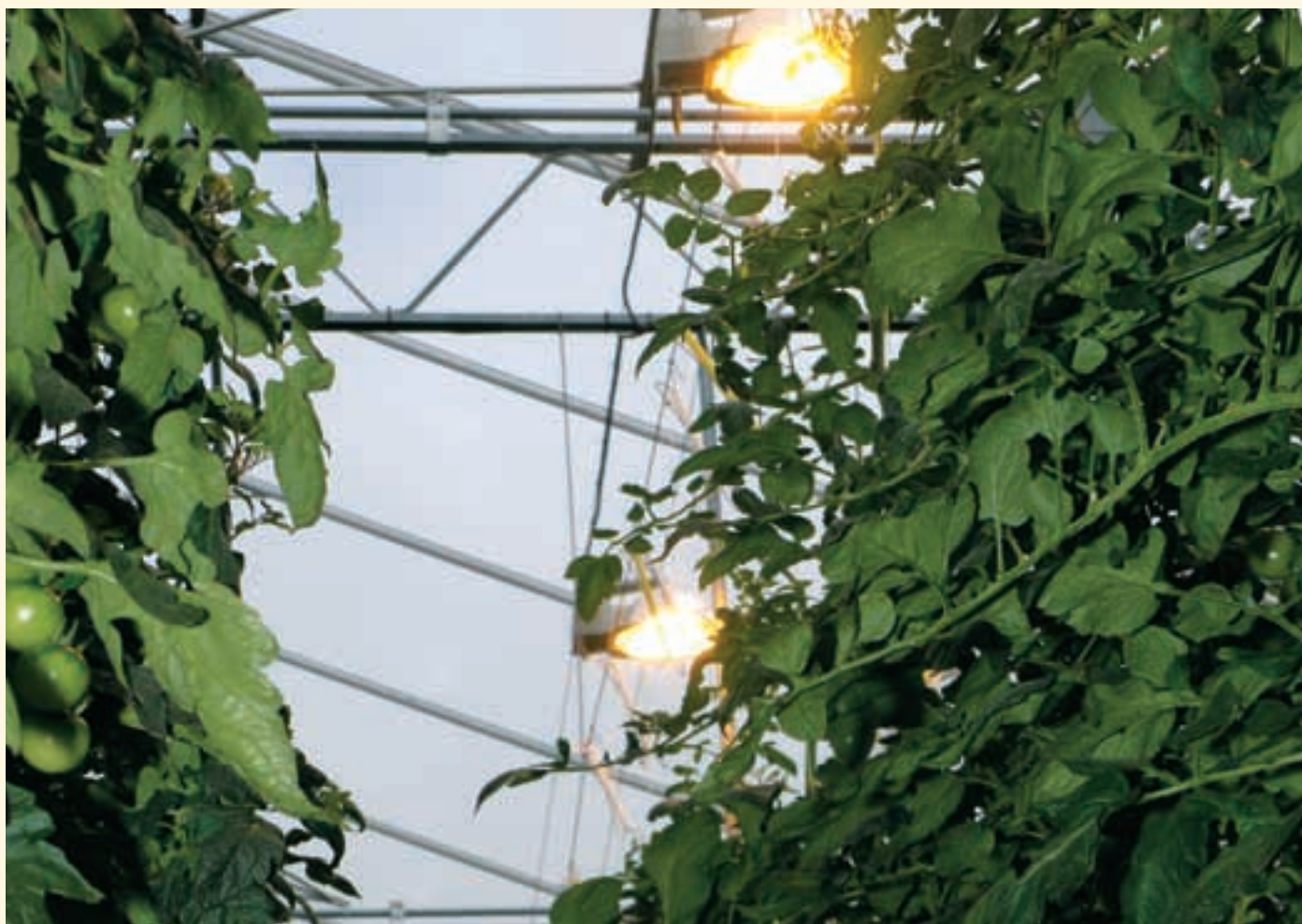
Een warmte/kracht-installatie zet gemiddeld 35% van de ingebrachte energie om in elektriciteit en 55% om in warmte.
