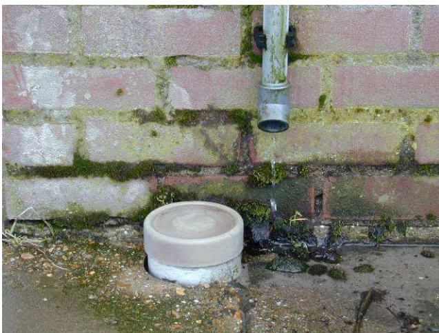
Condensafvoer aan de buitenkant van de cel
