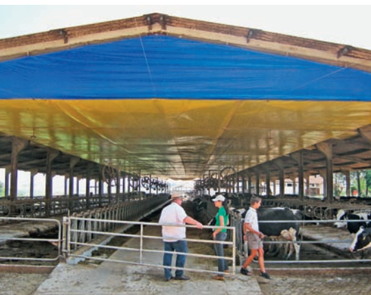
Dubbel plafond in staldak tegen de hitte
