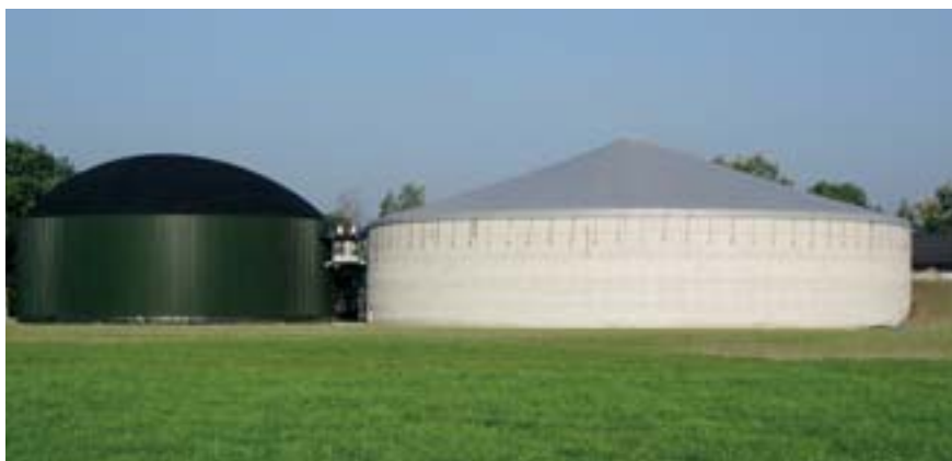
Een mestvergistingsinstallatie bestaat meestal uit een of meer hoofdvergisters en een of meerdere navergisters
