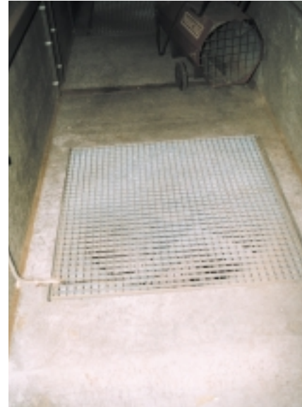
De ventilatie vindt plaats door langstroombeluchting
