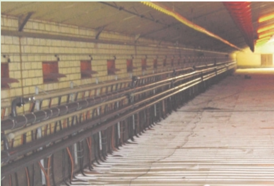
Leidingwerk en warmtewisselaars in een pluimveestal
