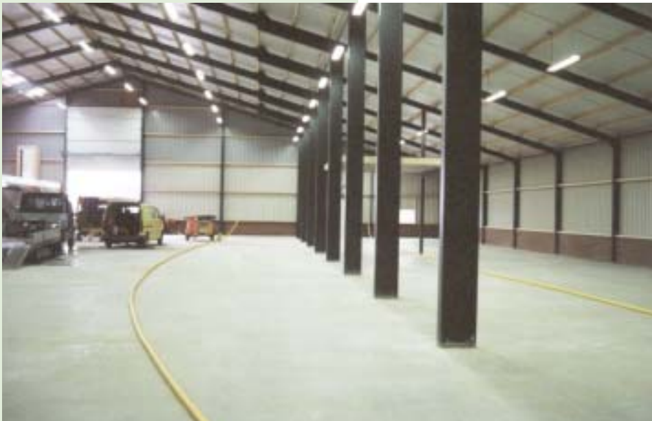
De loods is 36 bij 50 m en gaat onder meer veertien cellen bevatten
