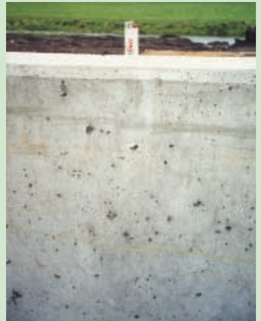
Luchtbelletjes in een silowand
