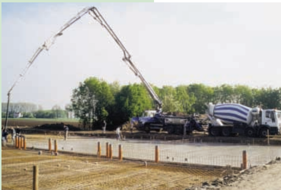
Betonsterkteklasse B25 voor een mestkeldervloer heet straks volgens de nieuwe norm C20/25 X A2
