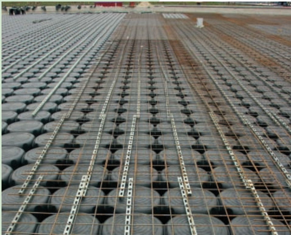
De lange lijn is hier toegepast als potentiële scheurinleider
