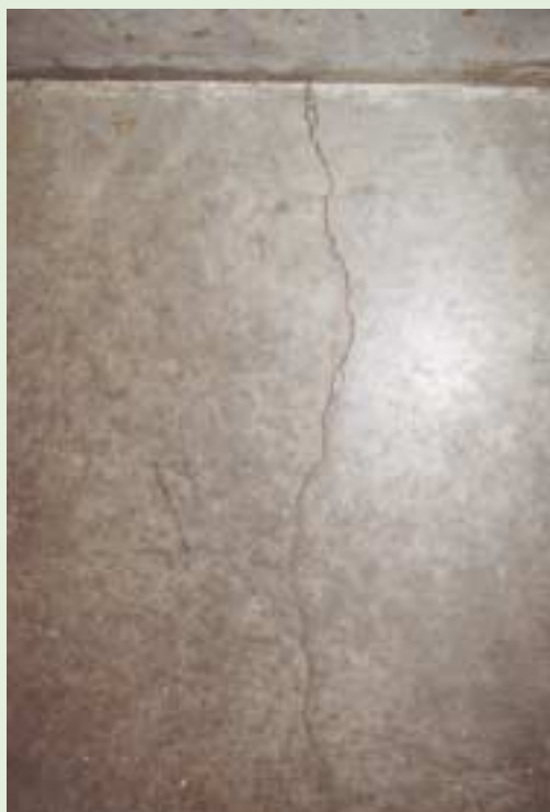
Het scheurrisico neemt sterk toe als er geen rekening wordt gehouden met ontwerp, betonsamenstelling, uitvoering en omgevingscondities
