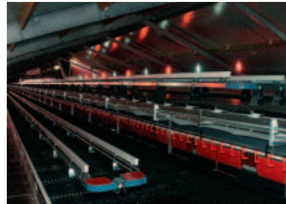
Op zolderniveau zijn de installaties gereed voor gebruik
