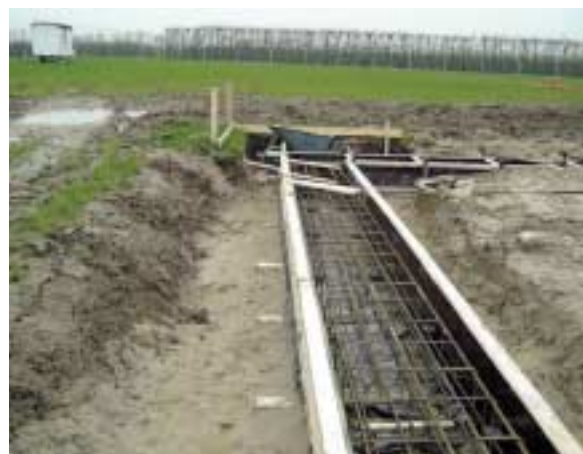
Voor de funderingsbalk is geen werkvloer gestort
