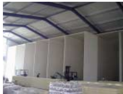
In de koelcellen komen de fruitkisten 10 hoog te staan. Dit geeft een vloerbelasting van 3,75 ton per m 2
