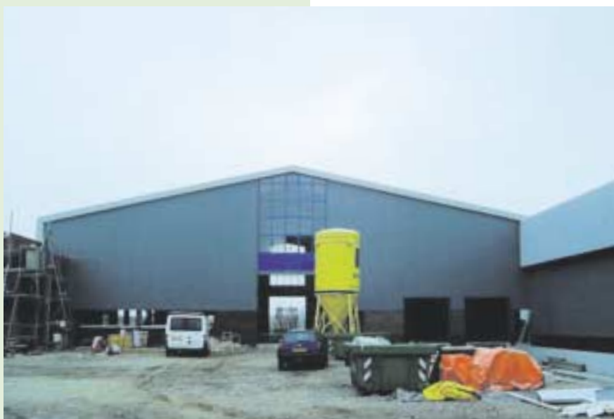
De laatste hand wordt gelegd aan de fruitteeltloods die fruitteler Anton van Wijk op 1 september in gebruik nam
